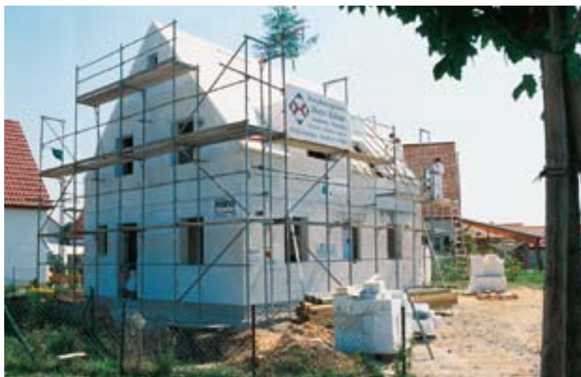
Le toit et les murs de cette maison sont doublés de panneaux isolants minéraux MULTIPOR.
